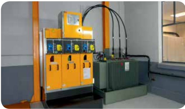
▷ Centrale de Ray-sur-Saône (70) : cellules HTA et transformateur
