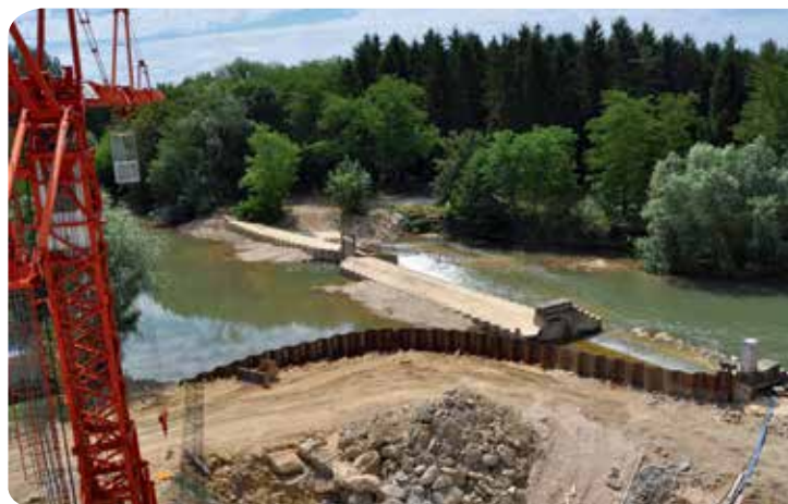
▷ Travaux 2014/2015 d'optimisation et de rénovation du Moulin de la Tête Noire – Brienon-sur-Armançon (89)
