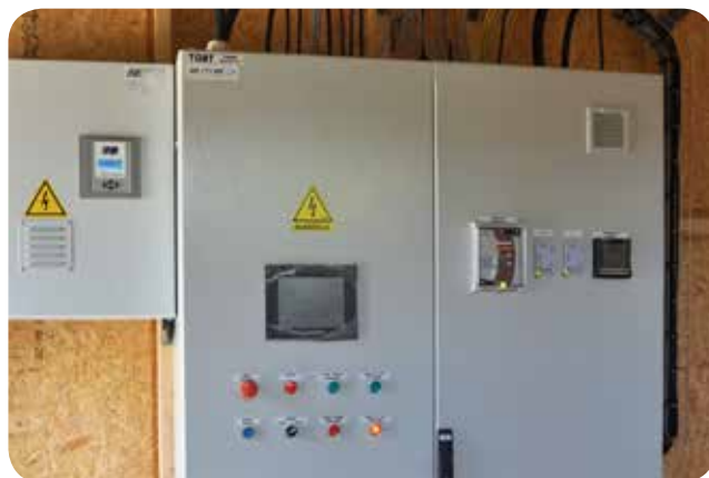
▷ Armoire de commande - Centrale de Champdôtre (21)
