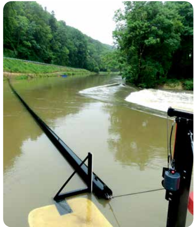
➤ Drome (avec système de contrepoids) pour détourner les objets flottants - Centrale de Ray-sur-Saône (70)
